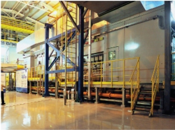
Фото 1. ГПА-32 «Ладoga» на КС «Вавожская»
